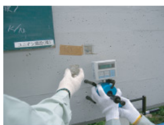
剥離試験:すべて躯体剥離
