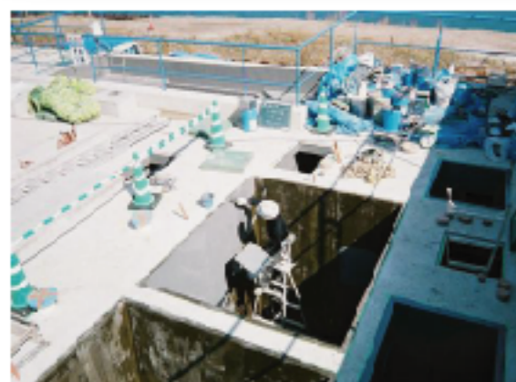
写真上 処理層内部全面(床・壁・天井)を順次こて塗り仕上げで施工しました
